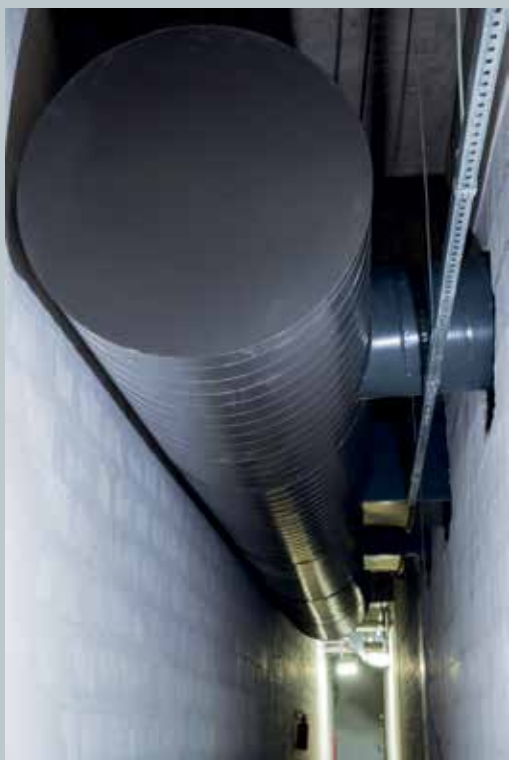
Sistema de exaustão promoverá eficiente troca de ar
